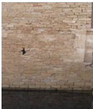
Η τοιχοποιία από πωρόλιθο τραχείας επιφάνειας έχει υποστεί διαφορετικού τύπου φθορά στη βάση της που θεμελιώνεται μέσα στην τάφρο (υψηλή υδατοαπορρόφηση) και στο 1/3 του ύψους της (κυψέλωση από κρυστάλλωση αλάτων).
