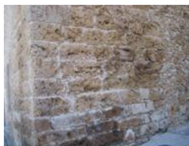
Κυψέλωση της δυτικής εξωτερικής τοιχοποιίας του Πολιτιστικού Κέντρου Χανίων στο παλιό λιμάνι
