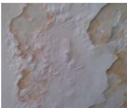
Εξάνθηση αλάτων και αποφλοίωση επιχρισμάτων από ανερχόμενη υγρασία.
